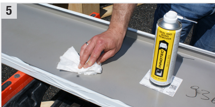
5 Fensterbank und Mauerabdeckung mit Seal and Bond Remover (Klebstoff- & Dichtmassenentferner) und Multi Wipes (Universaltuch) entfetten und mind. 5 Min. ablüften lassen.
